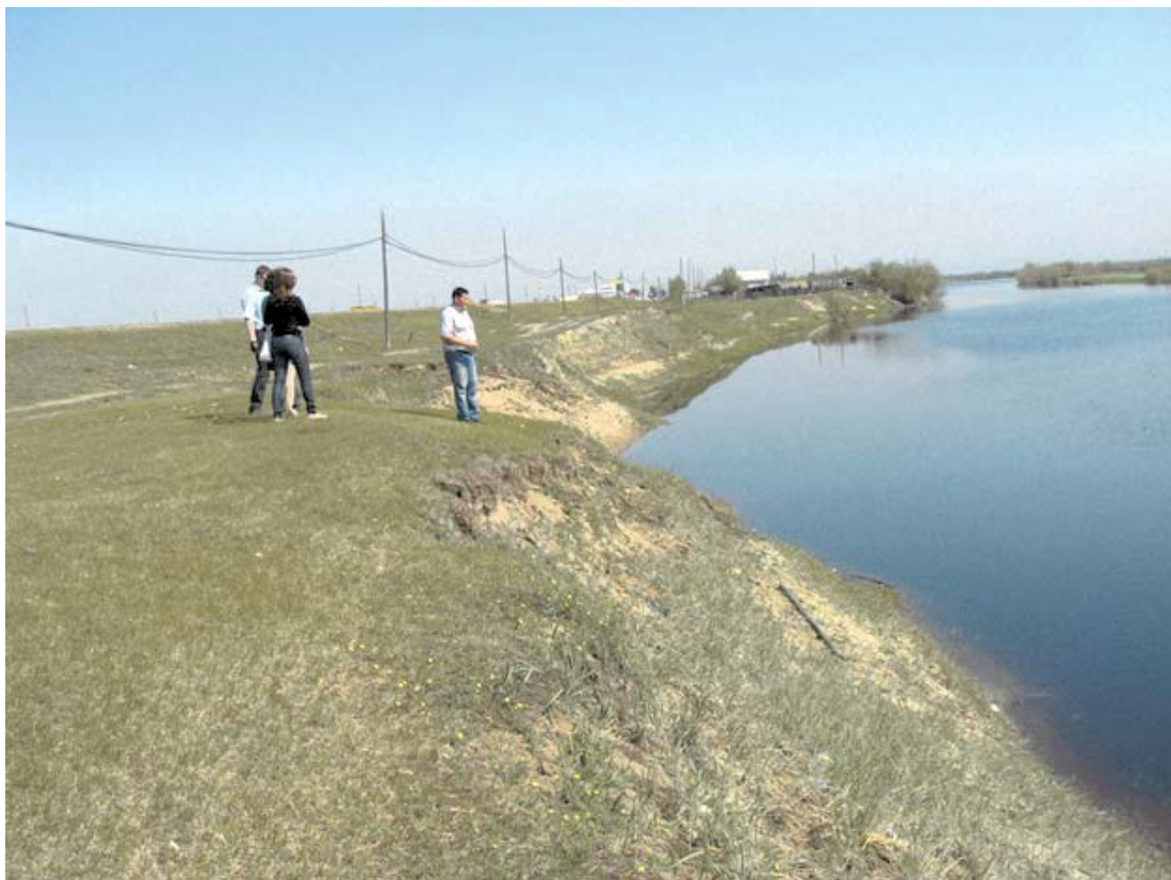
Фото 8.2.2. Разрушение берега у автодороги «Якутск – Намцы»
